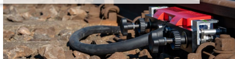
Le compteur d'essieux détecte les trains qui arrivent et transmet le signal à la station de base.
